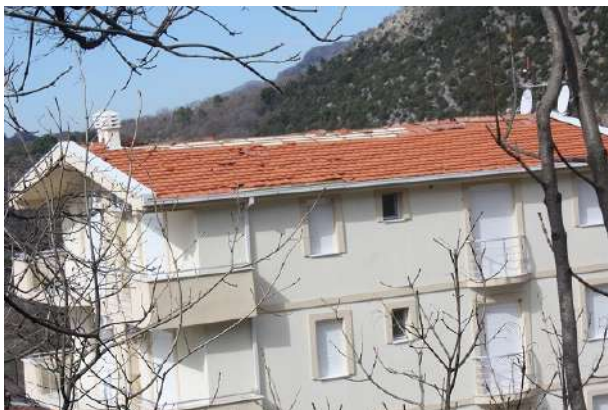
Повреждённая ураганом крыша гостиницы в Бырце
